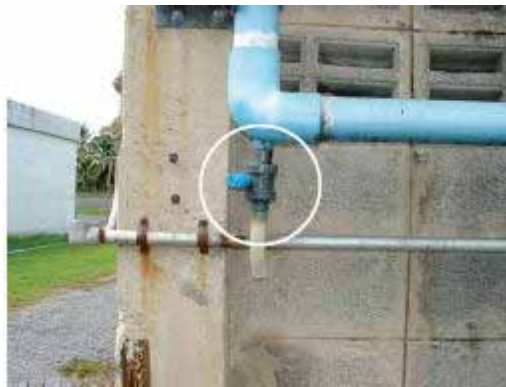
รูปที่ 5-46 จุดระบายน้ำที่ควบแน่นในเส้นออกจากท่อส่งก๊าซ
