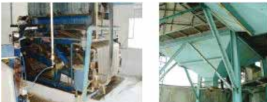
รูปที่ 5-21 ระบบรีดตะกอน
