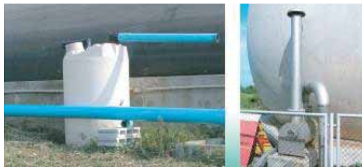
รูปที่ 3-11 อุปกรณ์ชุดควบคุมแรงดัน
