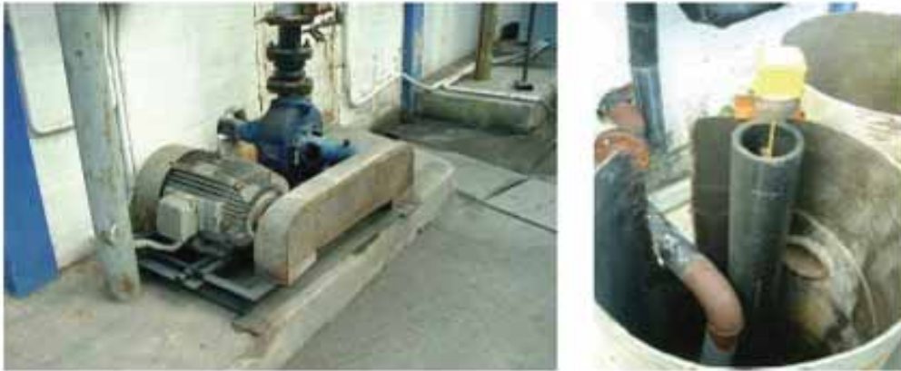
รูปที่ 5-2 บ่อสูบน้ำเสียและเครื่องสูบน้ำ
