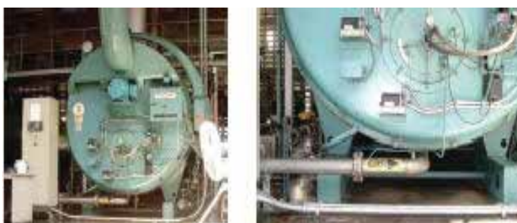
รูปที่ 5-41 หม้อไอน้ำ (Stream Boiler)
