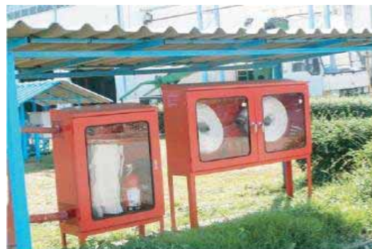
รูปที่ 3-35 การติดตั้งถังดับเพลิงใกล้ถังเก็บก๊าซชีวภาพ
