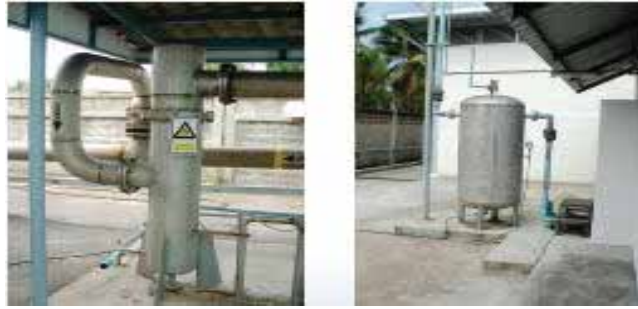
รูปที่ 5-45 ชุดไซโคลนดักน้ำก่อนเข้าไปในอุปกรณ์ใช้งาน
