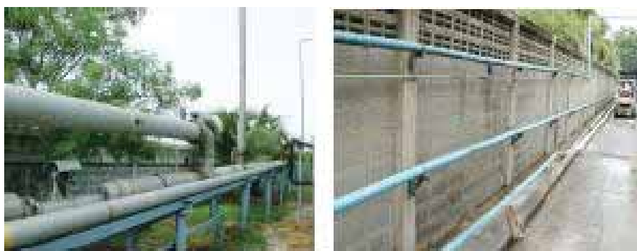
รูปที่ 5-44 ท่อส่งก๊าซชีวภาพ
