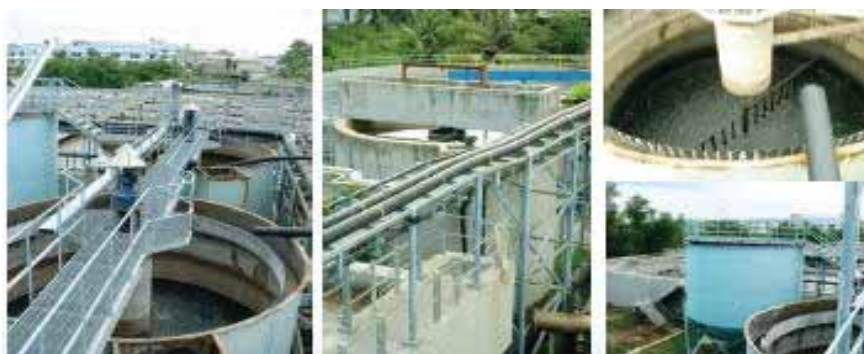
รูปที่ 5-19 ถังทำชั้นแบบต่าง ๆ (Sludge Thickener)
