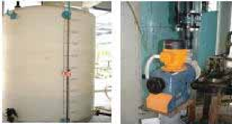
รูปที่ 5-25 ถังเก็บสารละลายโซดาไฟและเครื่องสูบละลายโซดาไฟ ( NaOH )
