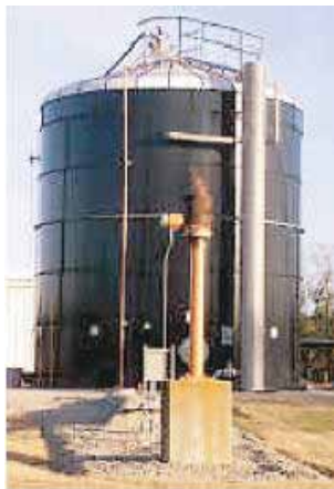
รูปที่ 5-38 ระบบถังกรองไม่ใช้อากาศ
