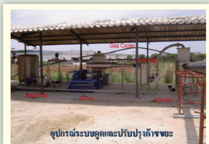
อุปกรณ์ระบบดูดและปรับปรุงก๊าซขยะ หลุมฝังกลบราชาเทวะ จังหวัดสมุทรปราการ
