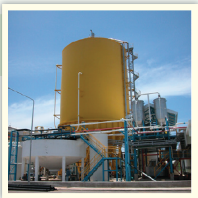
ถังหมักไร้อากาศ ของเทศบาลนครระยอง
